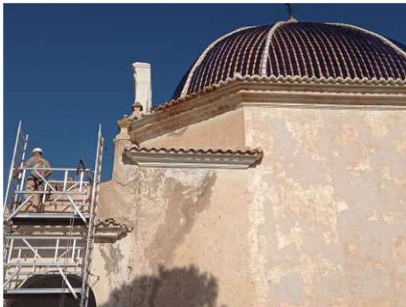
055. Encuentro de faldón y fachada en fase de intervención. Origen: teja porche, p. 10, imagen 5.
