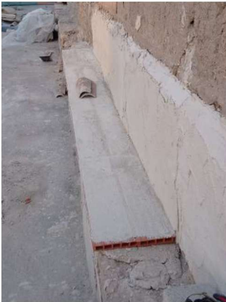
009. Detalle del saneado del revestimiento junto a un hueco. Origen: rascado pinturas, p. 9, imagen 5.
