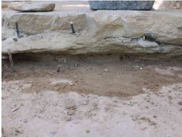
033. Pérdida de material en el frente de un peldaño.
