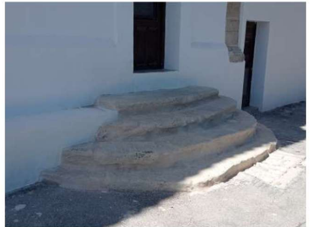
088. Estado final de la escalera de acceso a la casa del ermitaño. Origen: finales, p. 1, imagen 7.
