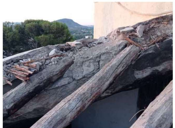
060. Deterioro de la madera visible al retirar la cobertura.
