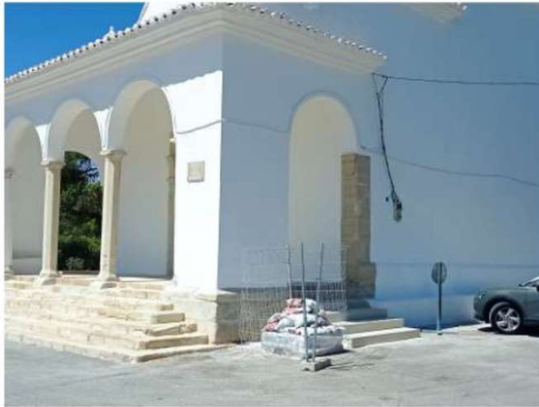
097. Vista del porche y de la esquina exterior reparada. Origen: finales, p. 2, imagen 8.
