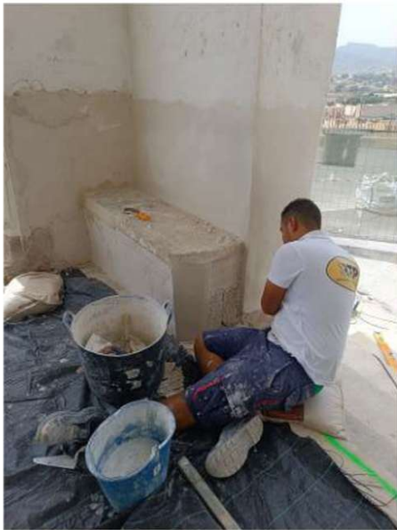
001. Saneado del revestimiento en el entorno de un hueco. Origen: rascado pinturas, p. 1, imagen 1.
