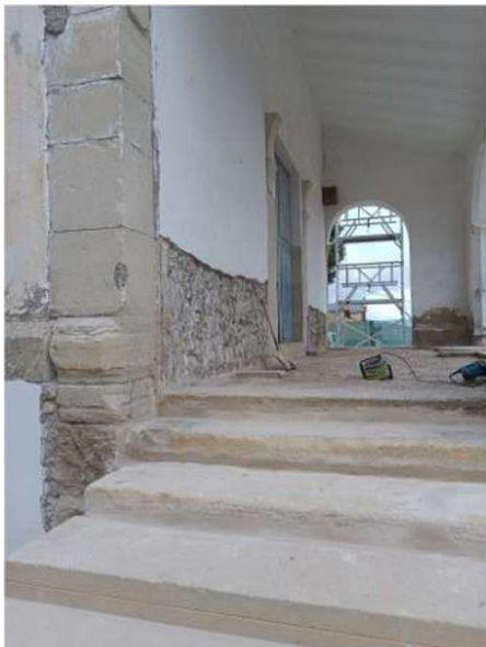
035. Encuentro entre escalinata y paramento saneado.
