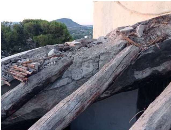
Fotografía 60. Deterioro de la madera visible al retirar la cobertura.
