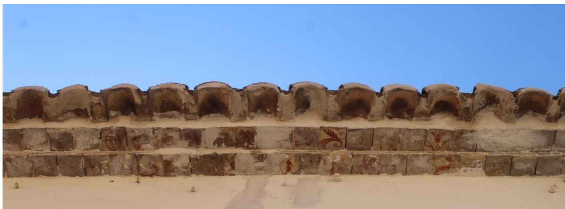
En la foto se puede ver, el enfoscado de cal, las pérdidas de ladrillos, y el estado deficiente de conservación
